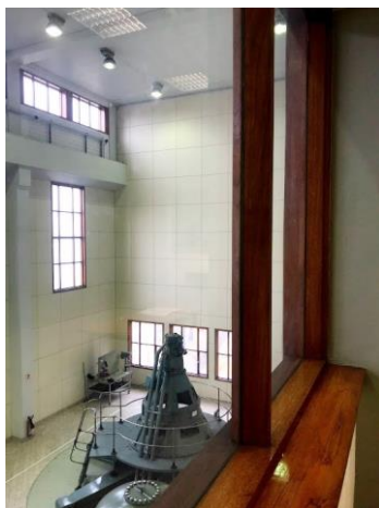
Horft yfir vélasal af efri hæð stöðvarhúss, 2018.
