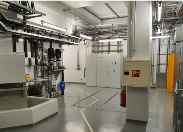
Innan úr stöðvarhúsi, 2020.
