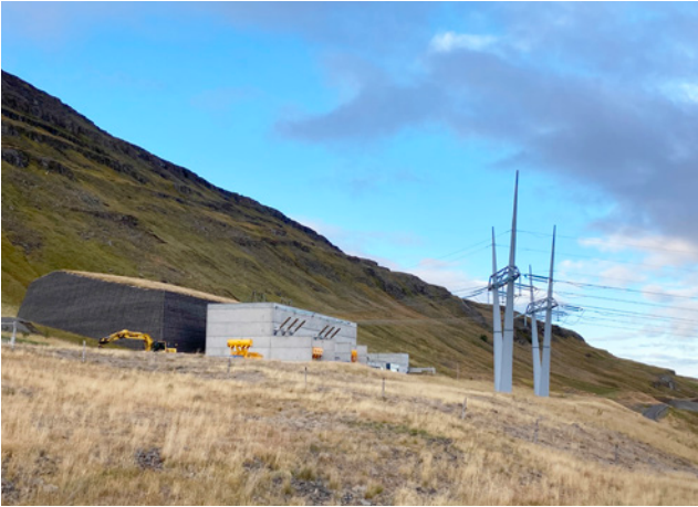
Tengivirki og snjóflóðavarnargarður og háspennumöstur, 2020.
