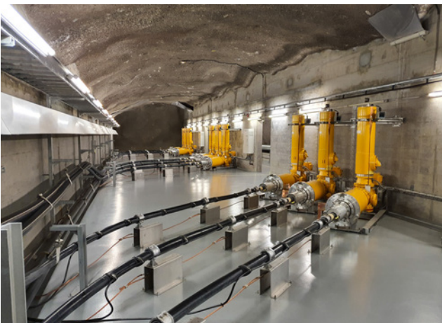
Innan úr stöðvarhúsi, 2020.
