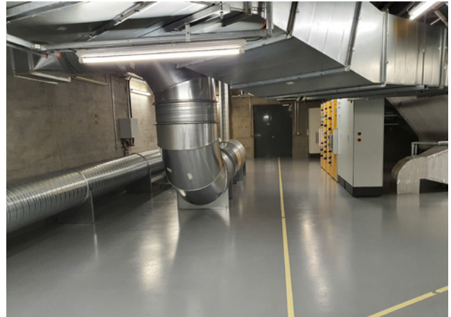
Innan úr stöðvarhúsi, 2020.
