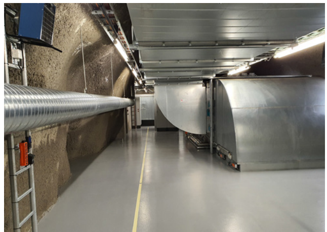
Innan úr stöðvarhúsi, 2020.
