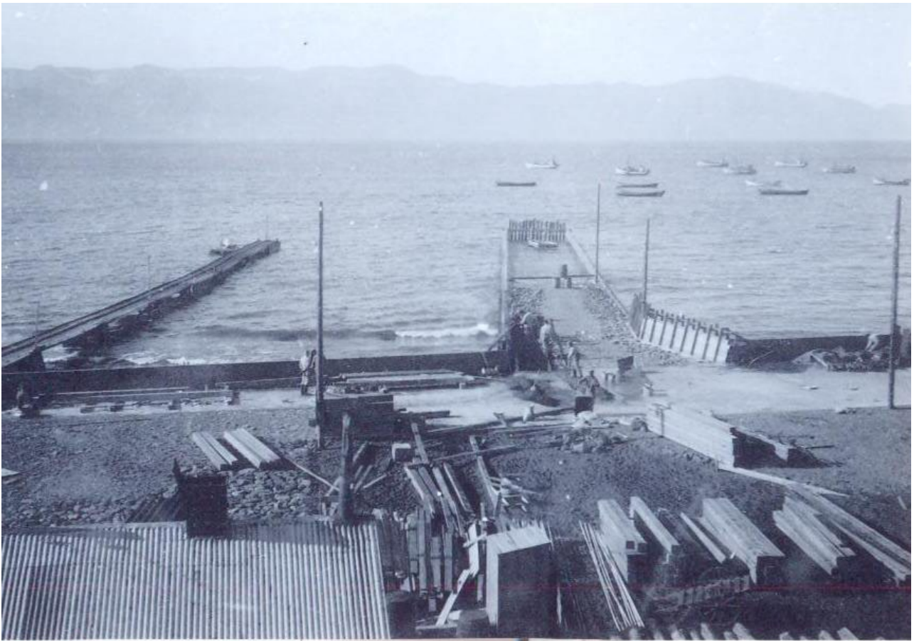
Hafin smíði hafskipabryggju. Vinstra megin er trépallabryggja á körum, eign Guðjohnsens. Tannhjólavinda dró vagna eftir járnspori frá bryggju og upp á sjávarbakkann. Ljósmynd tekin 1934.
