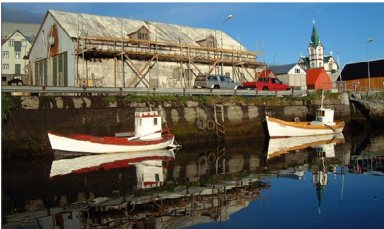
Unnið að endurbótum á húsinu í kringum árið 2000. Húsið er úr timbri nema vesturhliðin sem snýr að sjónum en hún er steipt. Ljósmyndari: Hafþór Hreiðarsson
