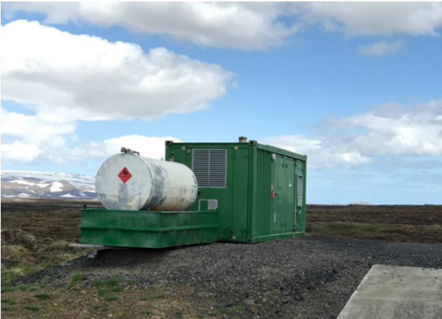
Rafstöð við borvatsnveituhús, 2020.
