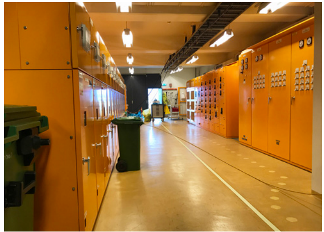
Innan úr stöðvarhúsi, 2020.
