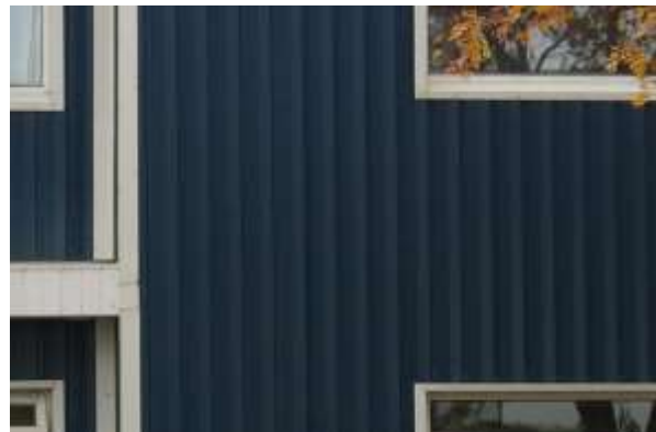
Gróf málmklæðning (viðgerð við Helgamagrastræti.)
